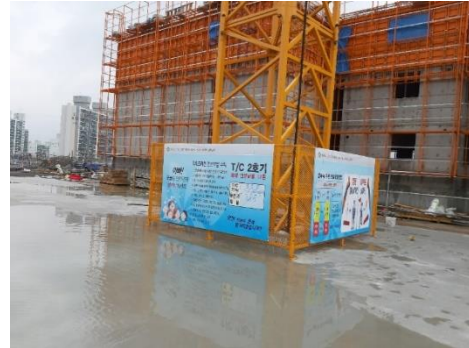
타워크레인 방호선반 및 간판
